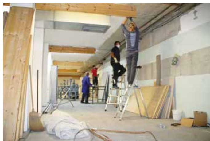
Über 150 Stunden halfen bereits Mitglieder der Griesstätter Schützengesellschaft seit Mitte März bei den bisherigen Arbeiten zum Umbau der Kleinkaliber-Schießanlage mit.
